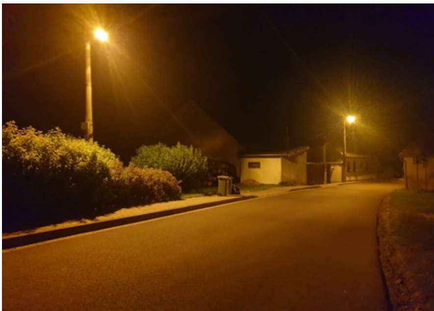
Jiratice (nedaleko Jemnice) – po celé obci je instalováno Biodynamické veřejné osvětlení. Foto: Zbyněk Svoboda
